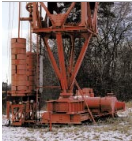
Der Mastfuß ist gegen Erde isoliert. Die Betongewichte an der Seite gleichen wechselnde Windlasten der Langwellenantenne aus.
