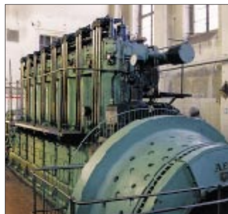
1000-PS-Dieselmotor im Maschinenraum des Senderhauses 1
