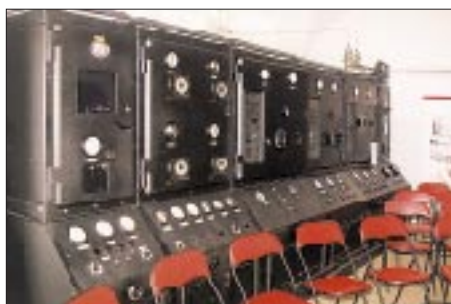
Ein 20-kW-Kurzwellensender der Firma Lorenz (Sender 13) ist im Vortragsraum aufgebaut
